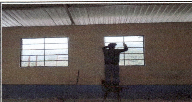
Foto 3: Se observa la sustitución de ventanas de madera por ventana de metal más vidrio.
